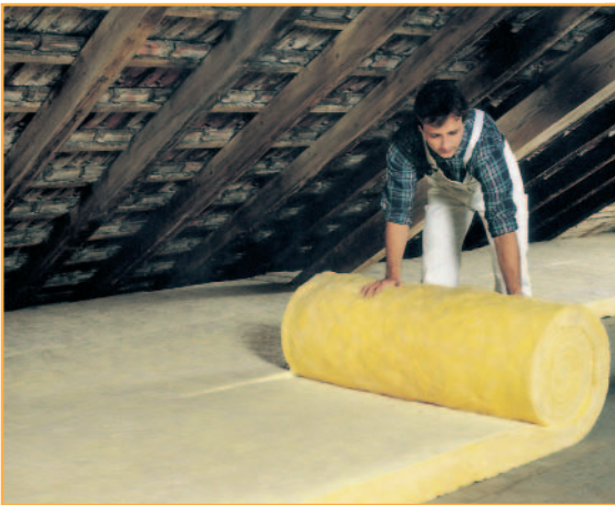
Dämmung oberste Geschoßdecke
